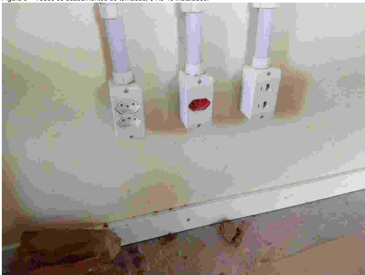
Figura 5 – Todos os acabamentos de tomadas, e RJ 45 instalados.
