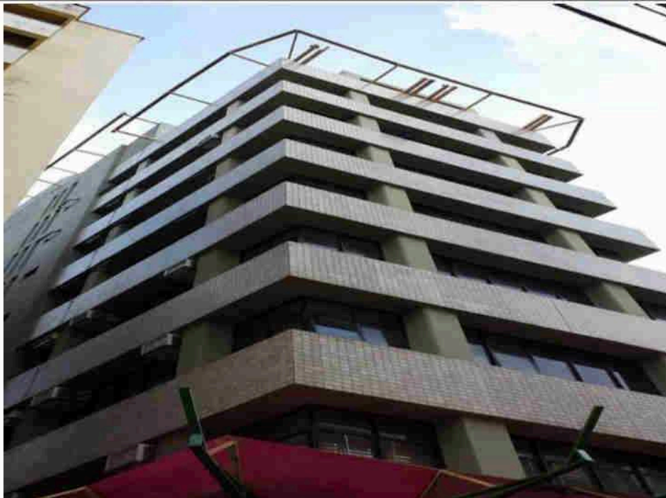
Estrutura para tela de proteção.
