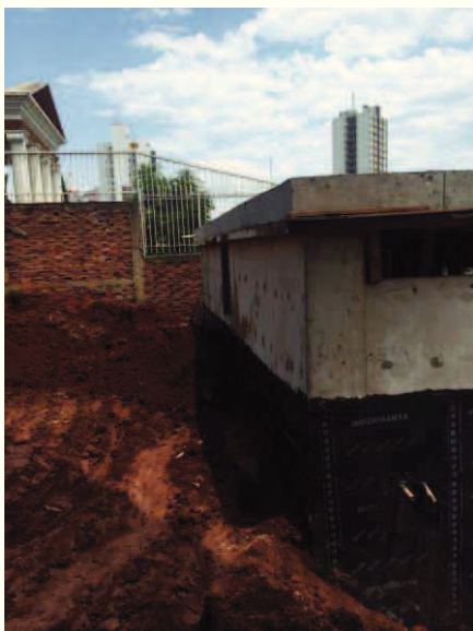
Imagem cisterna manta asfáltica
