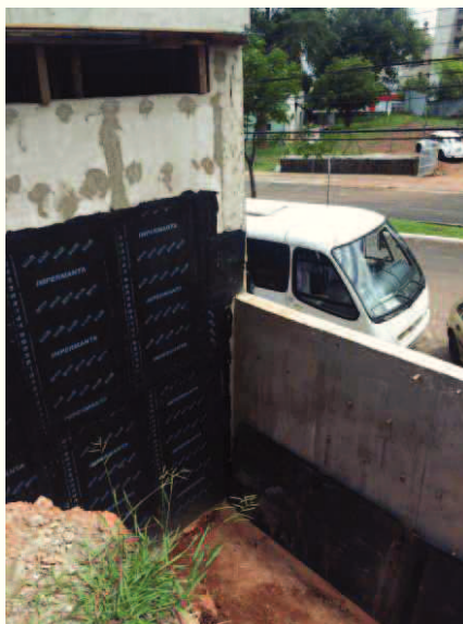
Imagem cisterna manta asfáltica
