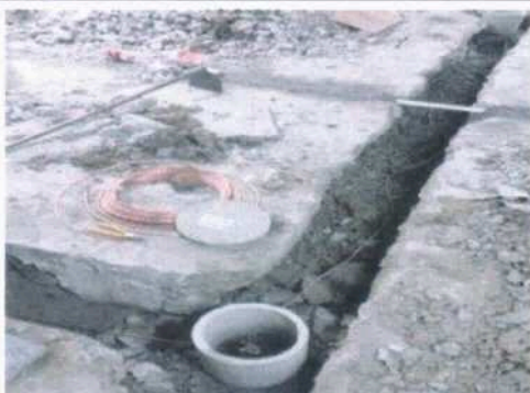
Malha de aterramento subsolo
