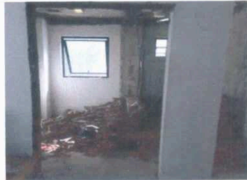
Demolição de parede de alvenaria existente conforme nova atualização de projeto arquitetônico pvto 6.
