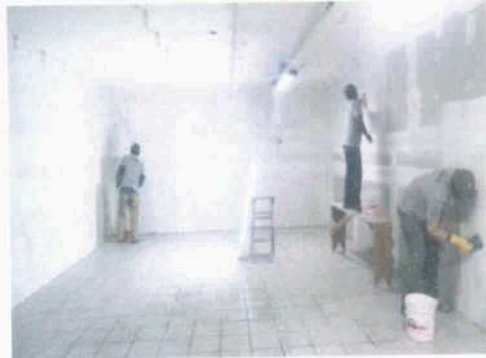
Aplicação de massa PVA em parede de dry wall com isolamento acústico em lâ de rocha no 7 pavimento.
