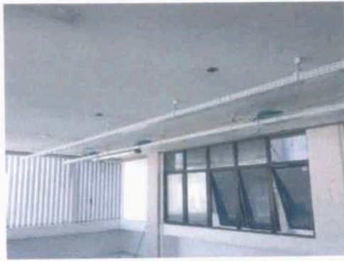
Eletrocalha iluminação pvto 7
