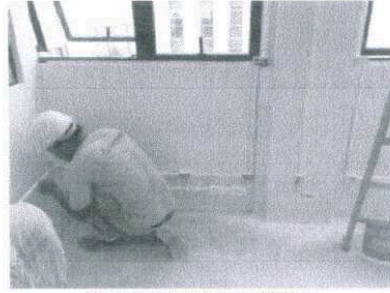
Fiação nas tubulações elétricas
