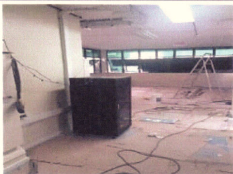
Instalações de Telecomunicações
