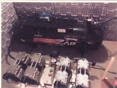
Instalação de compressor de Ar e bomba à vácuo
