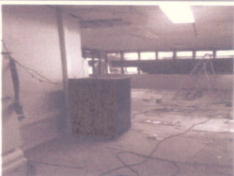
Instalações de Telecomunicações
