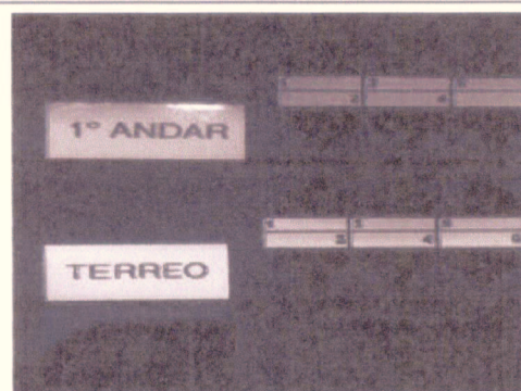
Instalações de Telecom
