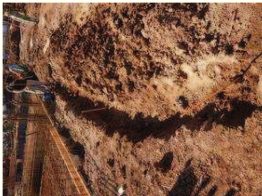
Hastes de aterramento
