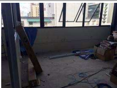
Instalações elétricas ático
