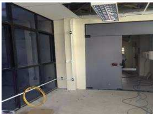
23/04/2015 - Instalações elétricas ático
