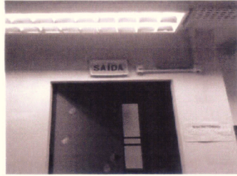
Instalações placas de saída
