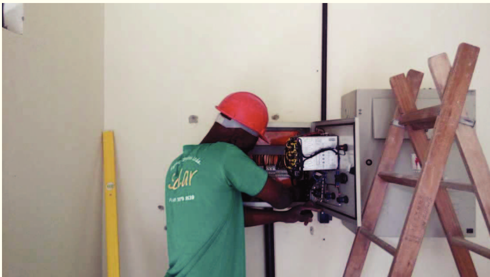
Figura 10 – Instalação elétrica (Substação)
