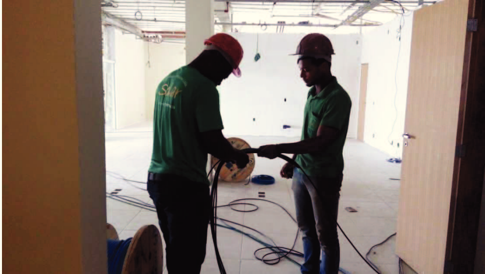
Figura 09 – Instalação elétrica (Prumada).
