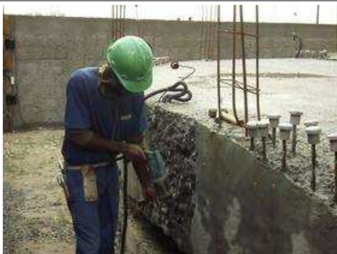
Conserto de defeitos de concretagem (bicheiras).
