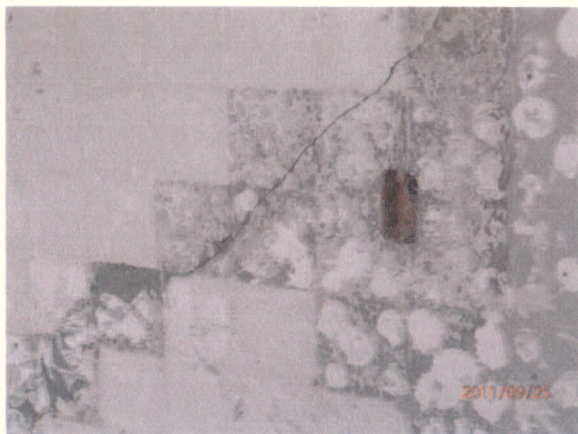
Foto 09 Mostrando Trinca a 45° após retirada de azulejos
