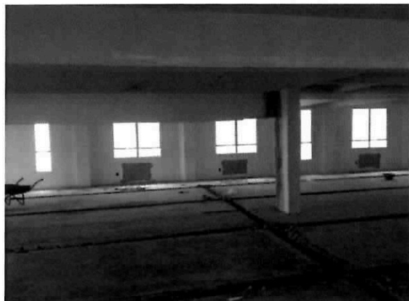
Foto 1 Revestimento aberturas ar condicion.
