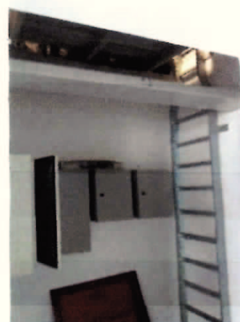
Foto 6 Pintura e quadros nos racks
