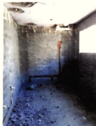
Foto 2. Instalações hidro sanitárias
