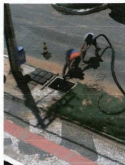
Passagem cabos entrada energia
