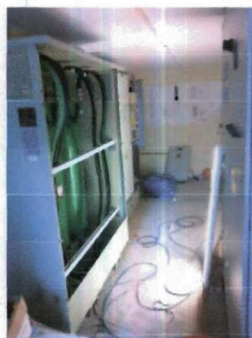
Instalação elétrica subestação
