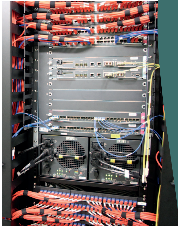
Hardware da sala-cofre do TRT: nova rede conta com equipamentos de maior capacidade e confiabilidade
