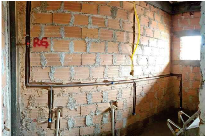
Sanitário PCD Masculino
